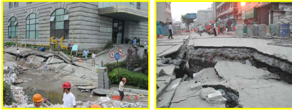
图 1 上海地铁四号线冻结法事故
