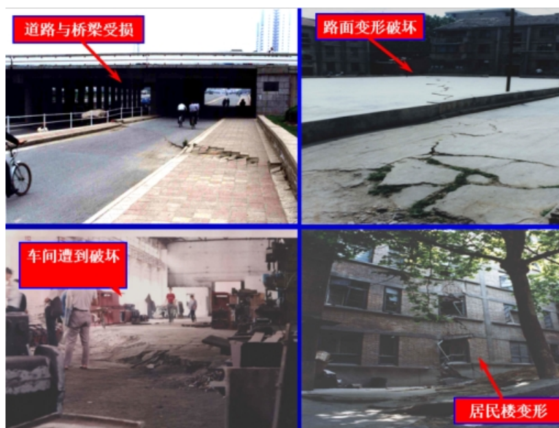
图1 地基处理不善导致的工程事故
